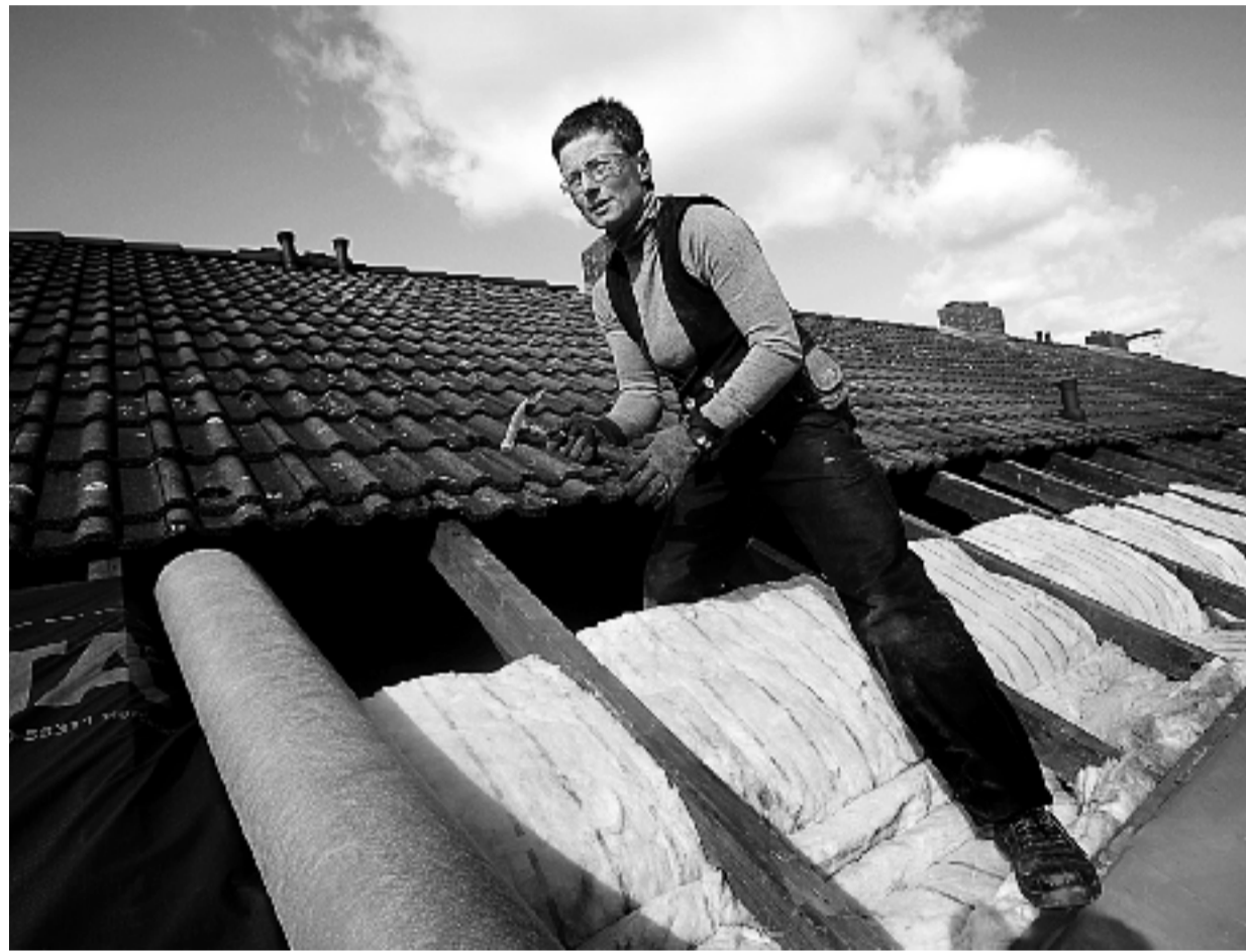
Energetische Sanierung – 2009 gab's 2,2 Milliarden Euro. 2011 sollen es nur noch 450 Millionen sein.
